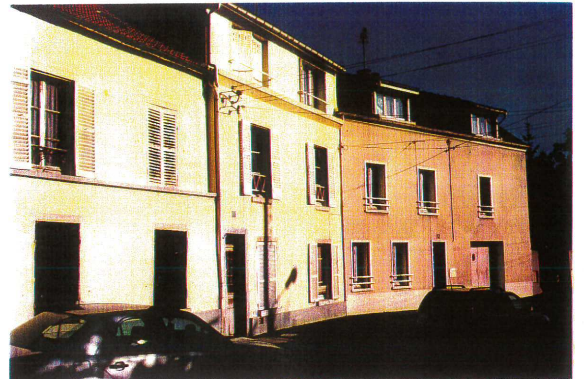
- n°14/16 rue Emmanuel Rain - garde-corps de différents types et surélévation.
