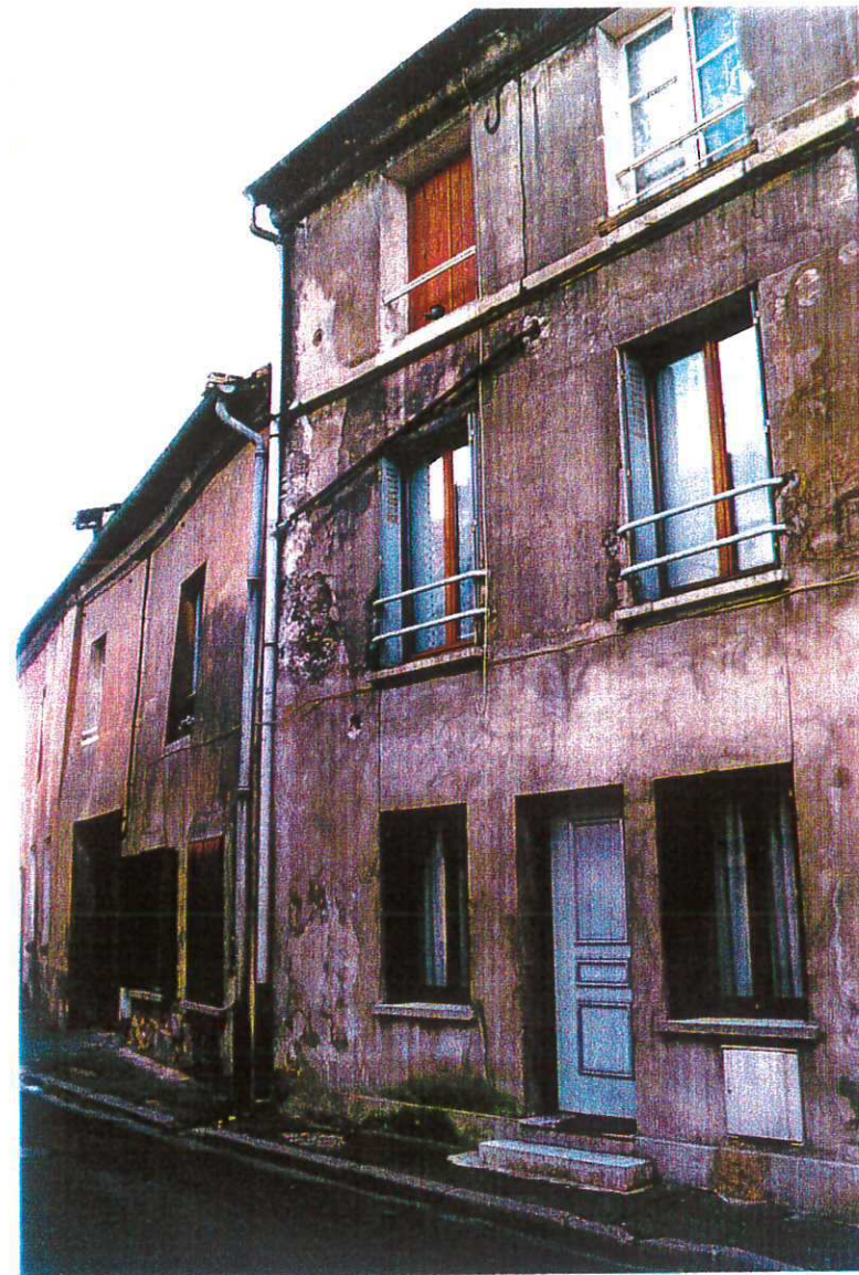
- n°56 rue Galande - construction mal entretenue - enduit ciment.
