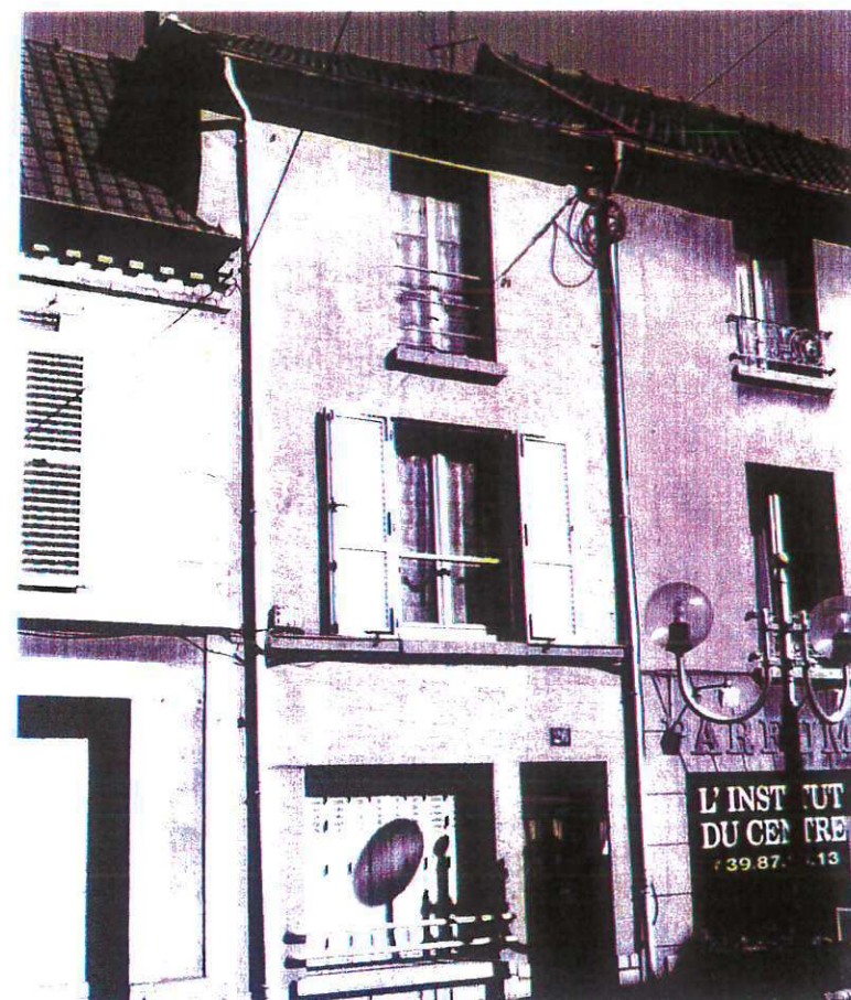
- n°26 rue du Général Leclerc - garde-corps de différents types.
