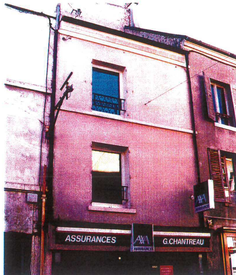
- n°48 rue de Paris - suppression des volets, transformation des ouvertures, garde-corps de piètre qualité.
